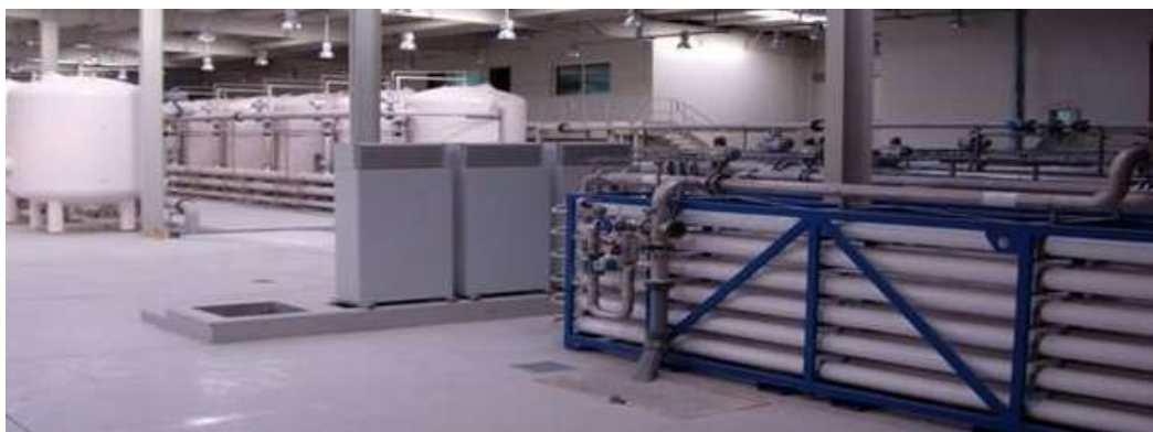
Крупная установка водоподготовки в Саудовской Аравии, 50.000 м 3 /сутки
